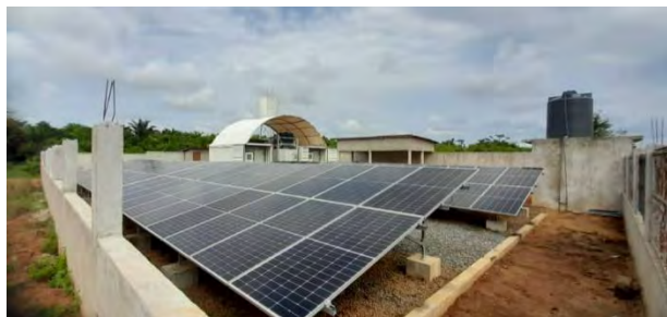
Figure 1: Une vue de l'installation des panneaux solaires
