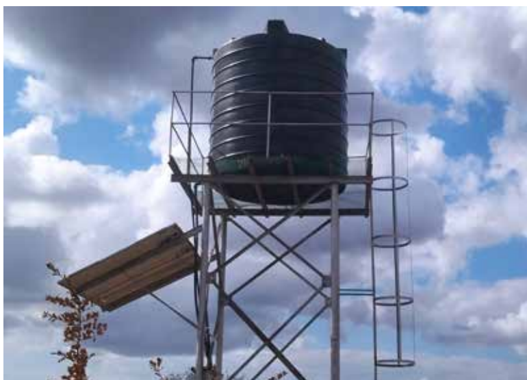
Tanque de sistema de agua COOPAMIM
