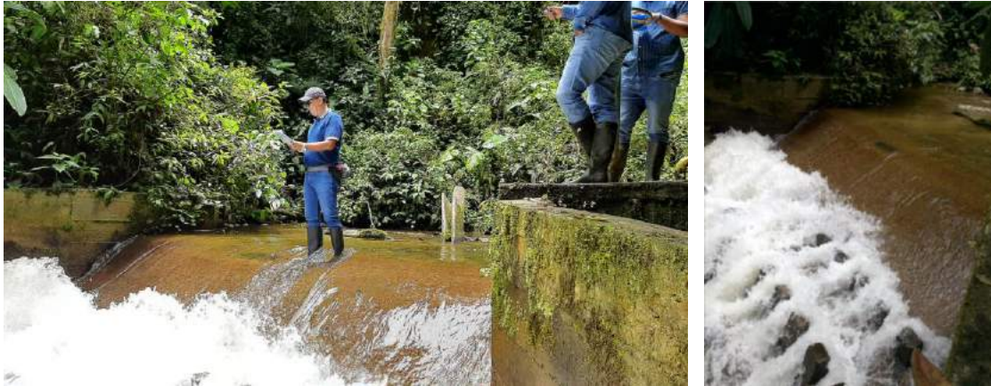
Figura 3. Captación en la quebrada El Puerto
