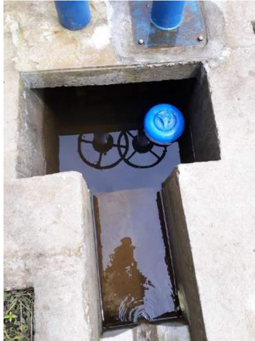
Figura 10. Canal de entrada a la PTAP
