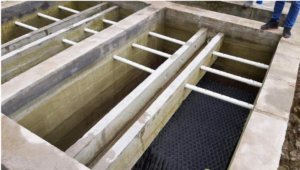
Figura 14. Decantador en tareas de vaciado de lodos
