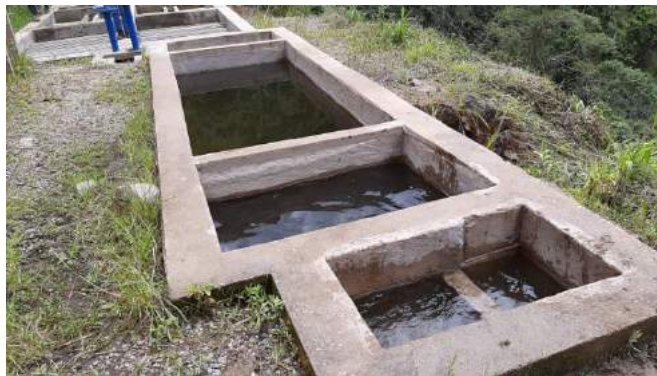
Figura 7. Vista del desarenador del acueducto Aguas del Atá
