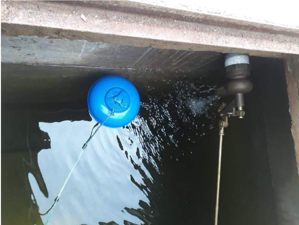
Figura 19. Dosificación de cloro y entrada regulada por válvula de flotador
