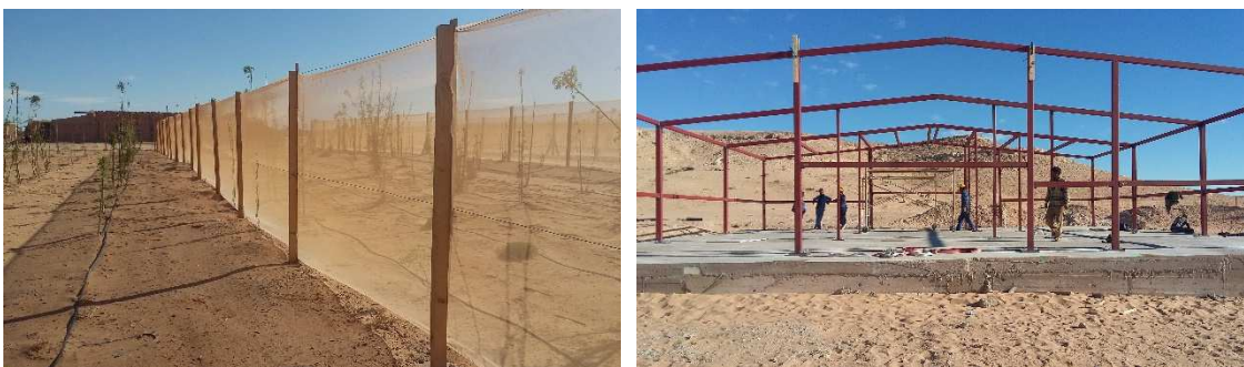
Imagen 8. Producción de moringa – Huerto de Bugarfa (izquierda) y planta de procesamiento de la moringa en construcción (derecha).
